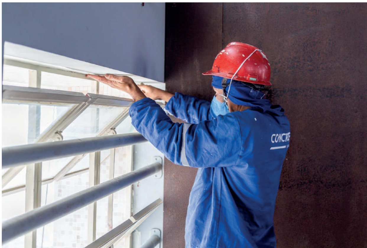
Restauração da fachada do Farol Santander - Edifício Altino Arantes em São Paulo, SP. Crédito da foto: Léo Giantomasi (fotógrafo de arquitetura)/ Acervo do autor.
