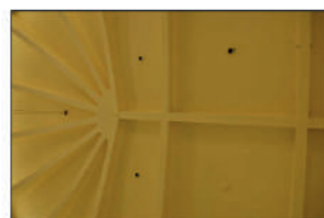
FOTO 03 - DSC_0046 Nervuras da laje de cobertura. Observar pontos de iluminação inutilizados, abertos e com caixa de passagem oxidada
