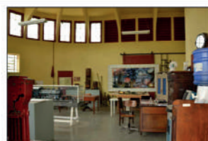
FOTO 01 - DSC_0040 Vista geral do ambiente 01. Observar esquadrias alteradas
