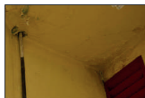
FOTO 04 - DSC_0051 Trincas e desprendimento de pintura na laje de cobertura. As manchas correspondem a antigas infiltrações, já tratadas.
